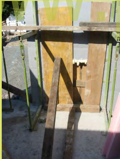
28_Schacht für den Heizungsverteiler
