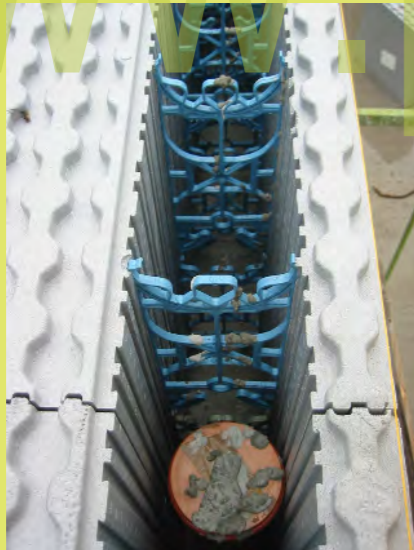
51_Kanalrohr im Betonkern
