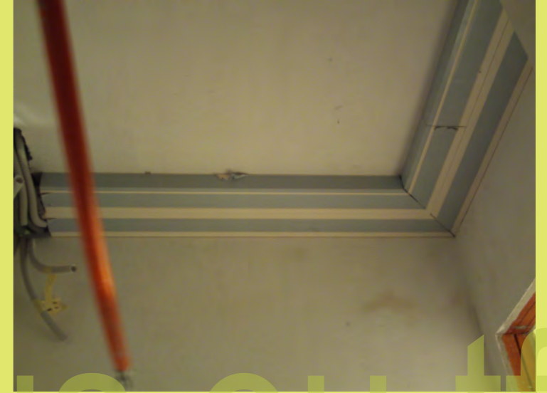
09_Endlich Ordnung - Kabelkanal im Technikraum
