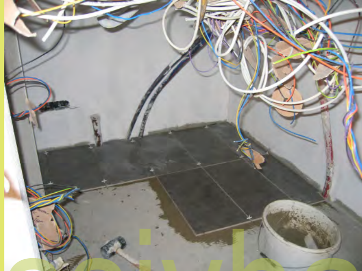
02_Fliesen im Technikraum
