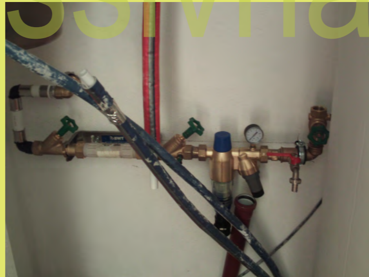
17_ Und da kommt mal unser Wasser rein
