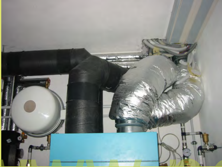
19_Die Lüftungsrohre sind ein anderes Kaliber
