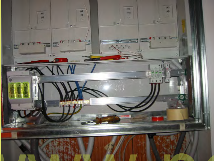
25_Zeit für Elektrik - der Vorzählerbereich
