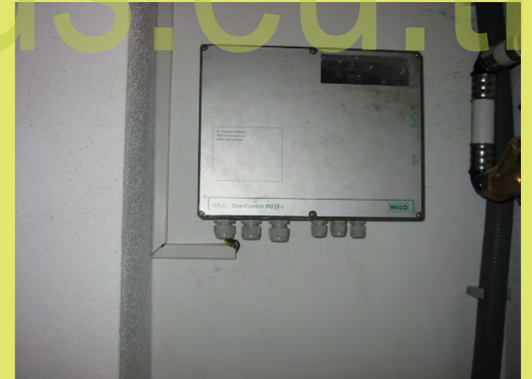
30_Das Steuergerät für die Hebeanlage ist montiert
