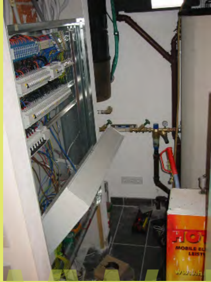
37_Zählerverkabelung im Verteiler
