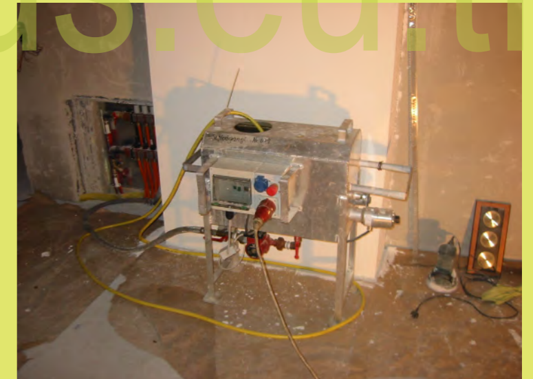
18_Das erste Ausheizgerät - nur für das EG
