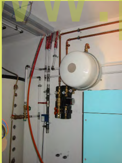
04_Das Ausdehngefäß für die Solaranlage
