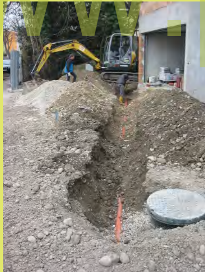
10_Auch das Wasser von der Garage wird benötigt
