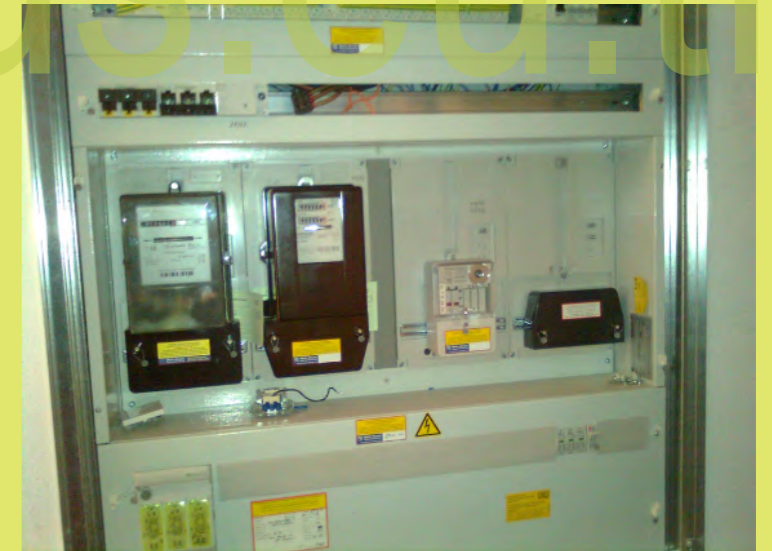
60_Der E-Verteiler wird in Betrieb genommen
