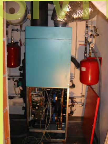
17_Das Kompaktgerät wird verkabelt
