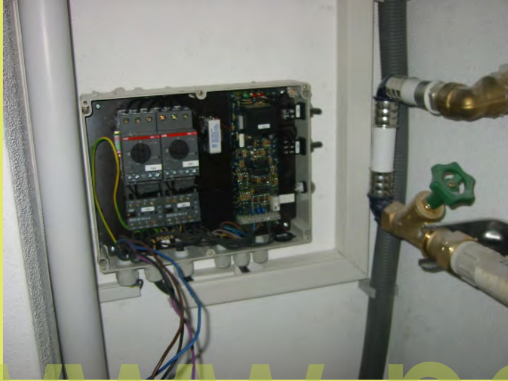
25_E-Anschluss der Hebeanlage
