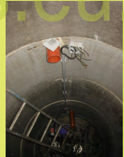
24_ Untertage - der E-Anschluss der Hebeanlage
