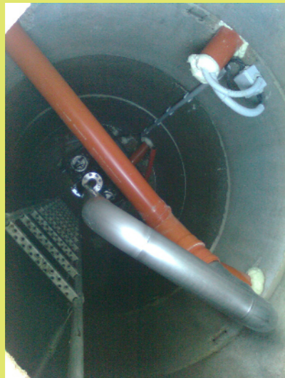
07_Und auch elektrisch angeschlossen
